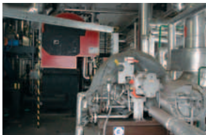
Strojovna kotelny na dřevní štěpku The machine room of the heating plant processing the wood chips
