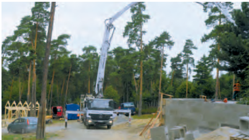
Výstavba vyhlídky v euroasijské části safari /Construction of a view point at the Eurasian safari/
