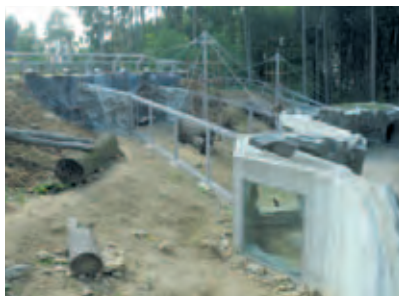
Výstavba chovného centra pro levharty mandžuské /Construction of the breeding centre for leopards/
